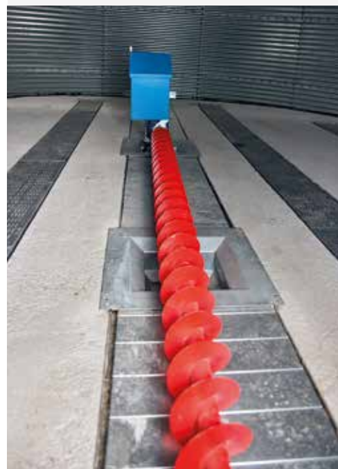
Vis racleuse dans un silo avec caniveaux de ventilation
