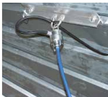
Suspension sous le toit d'un silo
