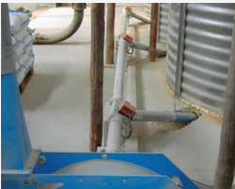
Prélèvement au silo à l'aide de vannes d'aspiration
