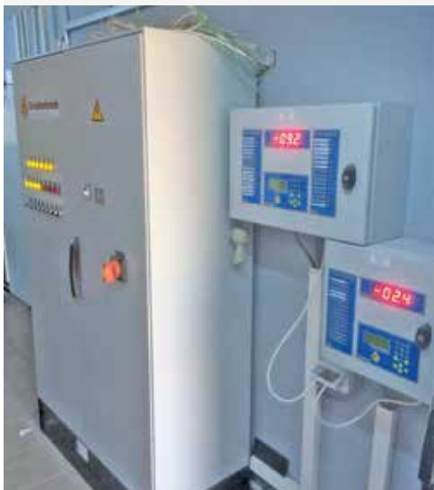
Armoire électrique HIMEL avec WDC64
