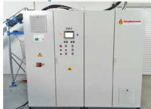
Armoire électrique avec commande par groupes
