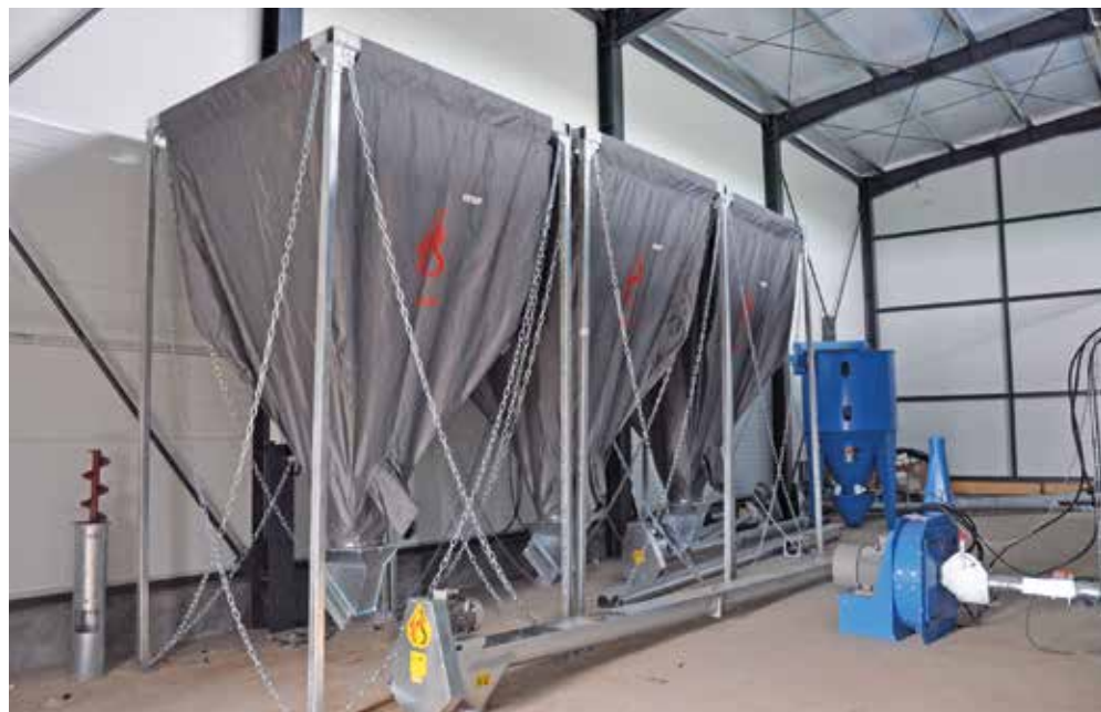
Silos textiles résistants aux UV avec mélangeur d'aliments et broyeur avec aspiration et refoulement
