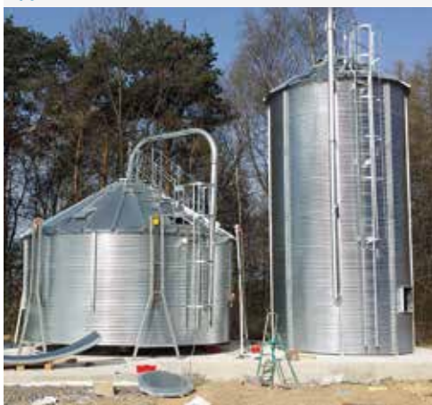
Silos extérieurs avec conduites de remplissage
