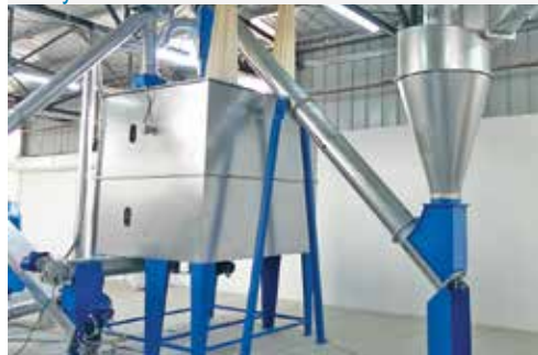
Réservoir tampon avec agitateur
