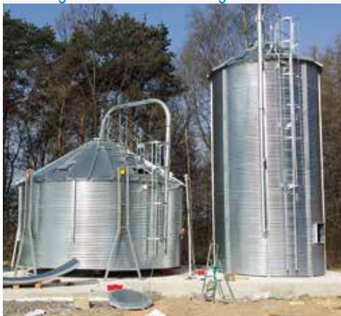
Außensilos mit Rohrleitungen zur Befüllung
