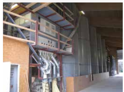
Anlage mit 4000 t Lager und Siebreiniger
