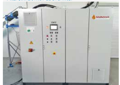
Schaltschrank mit Gruppenschaltung
