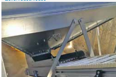
Förderband am Austrag des Kühlsilos
