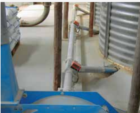
Siloentnahme über Saugventile
