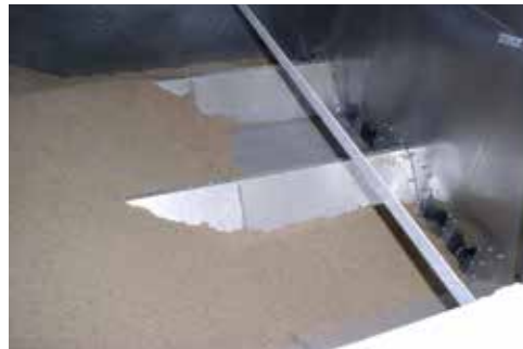
Dachreiter-Belüftungskanäle im eingebauten Zustand
