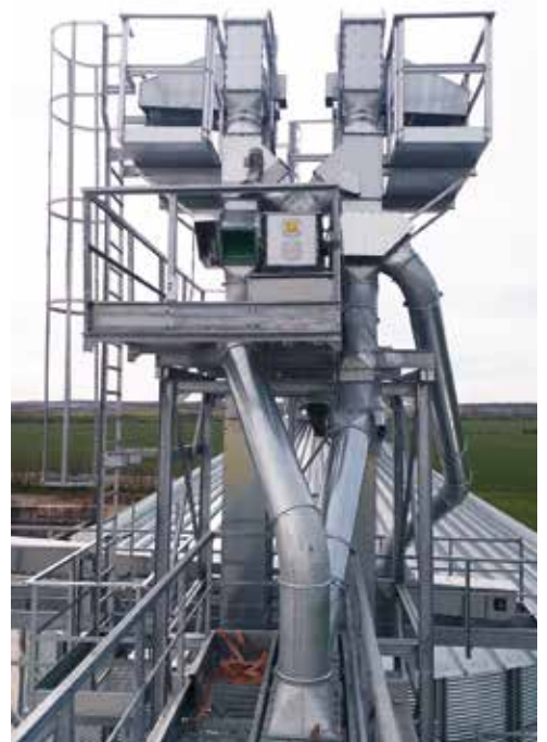
Becherelevator mit Aufstiegsleiter und Podest
